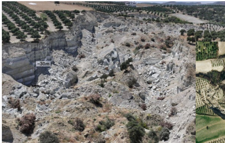
Landslide in Tepehan, Hatay [Görüm et al 2023]
